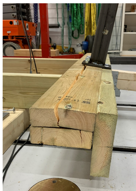
Figur 33 Topplanke og kubbing sprekker.
