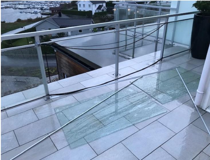
Figur 2 Glasset har blåst ned ved vindlaster som glassrekkverket skulle vært dimensjonert for. Bildet er gjengitt med tillatelse fra sameiet. Foto: SINTEF
